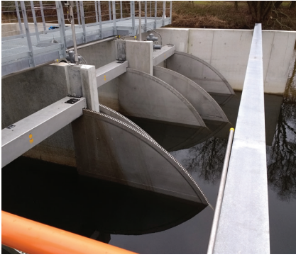
图 3. 曝气通道出口处的可调出水堰。
